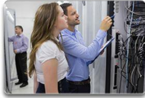
Se deben inspeccionar las instalaciones para detectar daños.
