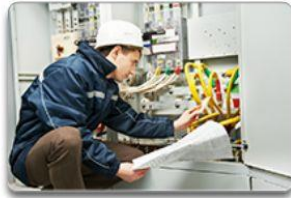
La separación del cableado de datos y el de energía eléctrica debe cumplir con los códigos de seguridad.
